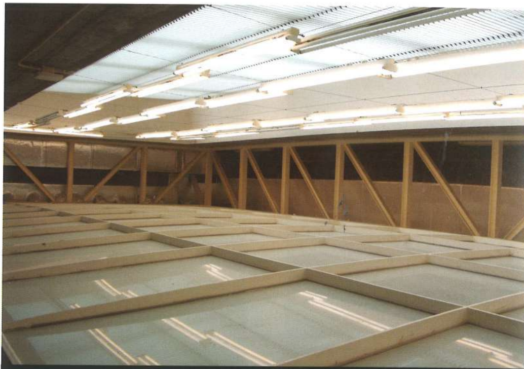
Piso técnico do Museu de Serralves onde se aplicou uma persiana e um sensor crepuscular que adequa automaticamente a luminosidade pretendida dentro do espaço expositivo
